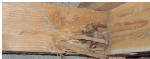
シロアリによる床下の被害①
